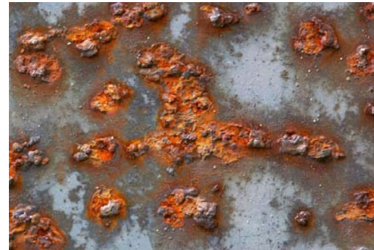
Corrosion et rouille
